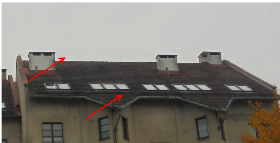
Rys. 3. Zabrudzenia na powierzchni kominów. Korozja obróbek blacharskich [1.4.].
