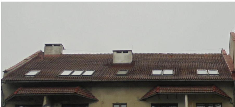
Rys. 4. Zabrudzenia i zacieki na powierzchni dachu i kominów. [1.4.].
