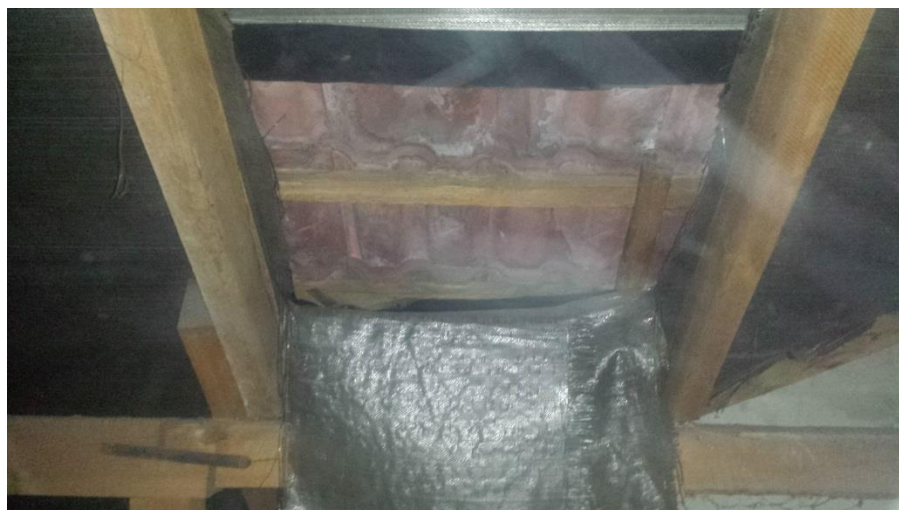
Rys. nr 7. Uszkodzenie wiatroizolacji. [1.4].
