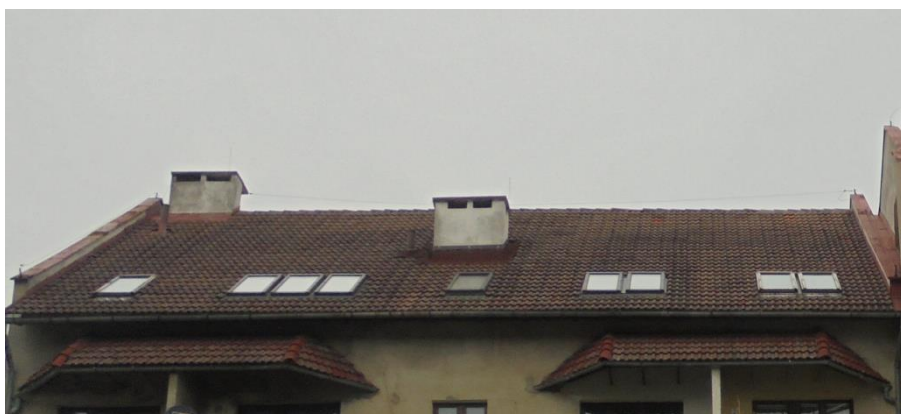
Rys. nr 4,5,6. Zabrudzenia i zacieki na powierzchni dachu i kominów. [1.4].
