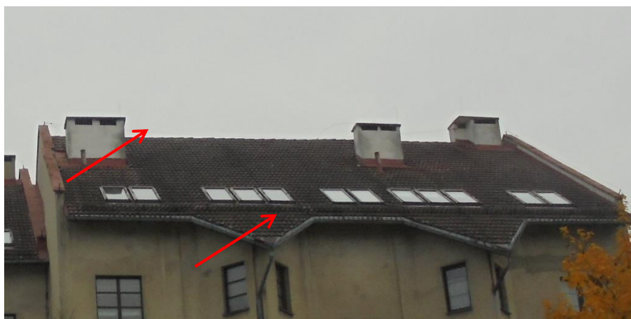
Rys. nr 3. Zabrudzenia na powierzchni kominów. Korozja obróbek blacharskich [1.4.].
