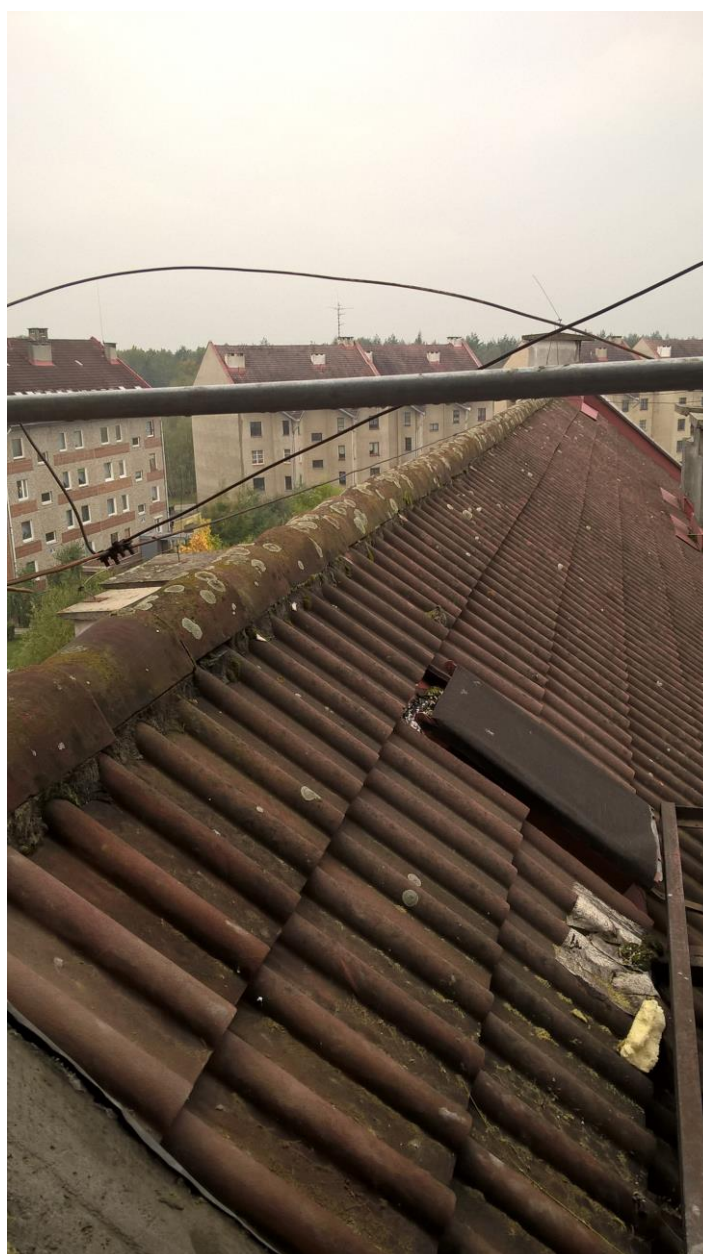
Rys. nr 7. Zabrudzenia na powierzchni dachu. Rozwój mikroorganizmów. Korozja wyłazu dachowego [1.4.]
