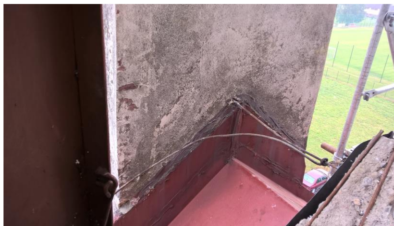
Rys. nr 8. Zabrudzenia i zacieki na powierzchni kominów[1.4.].
