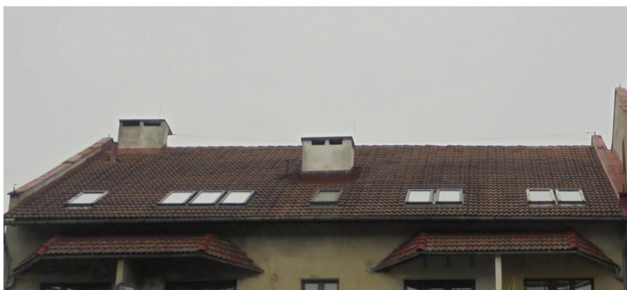
Rys. nr 4,5,6. Zabrudzenia i zacieki na powierzchni dachu i kominów. [1.4].
